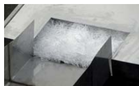
Abwasserfiltration vor dem Ableiten in das Abwassersystem
